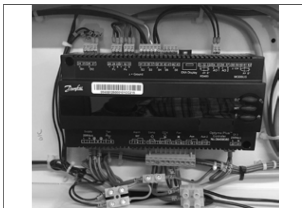
Bilde 5: Midlertidig kabling
