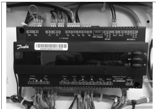
Bilde 4: Normal kabling
